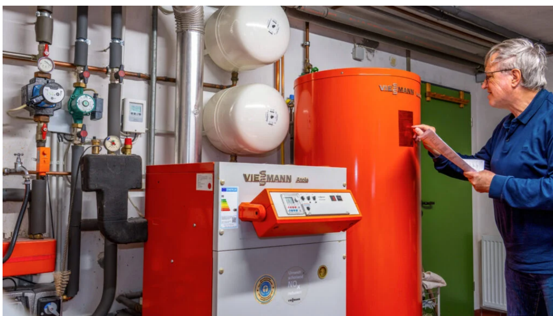
Wie lange darf sie noch laufen? Ein Rentner kontrolliert seine ältere Gasheizung mit Warmwasserspeicher (Symbolbild). (IMAGO/Wolfgang Maria Weber)
